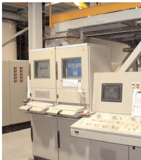
Ordenador de control de sala de mezclas
